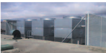
3.18 Tours de refroidissement
