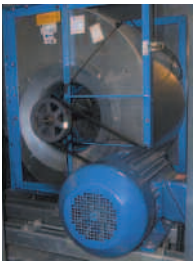
3.9 Ventilateur d'alimentation type centrifuge
