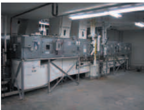
1.1 Système de ventilation et de conditionnement de l'air
