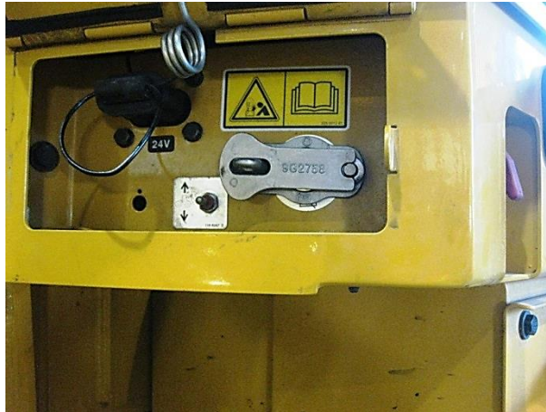
Figure 12 : Coupe-batterie cadenassable de la chargeuse prêt à recevoir un morillon et les cadenas personnels de tous les intervenants.
