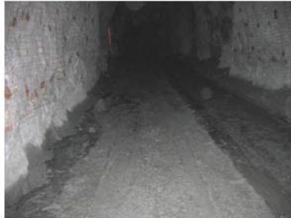
État de la rampe entre le point de chargement et de déchargement de rugosité inférieure à la moyenne. Très bonne condition.
