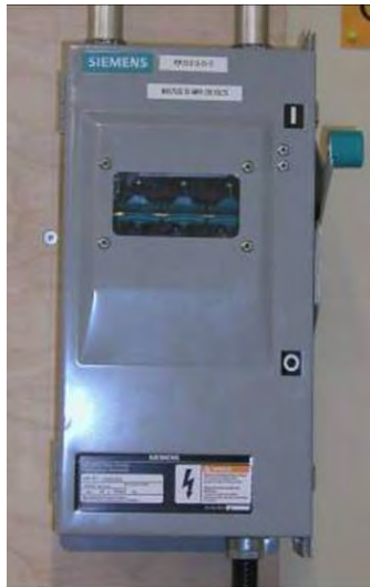
Figure 10: Sectionneur à fusibles principal
