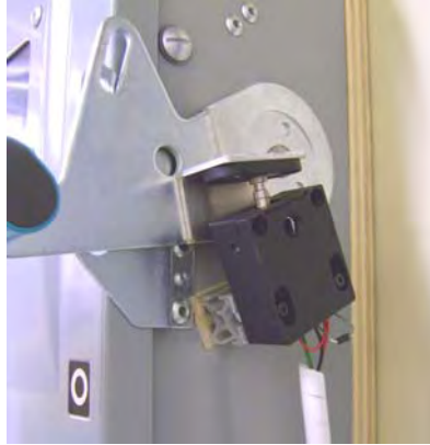
Figure 25: Cadenas électronique installé sur le sectionneur à fusibles
