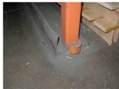
Figure 25 : Cornière de protection du palettier tordue
