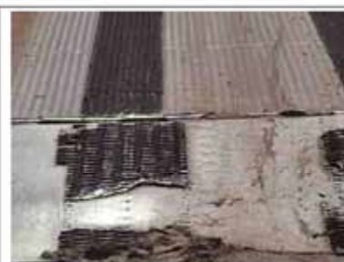
Caillebotis endommagé à cause de la pente. Surface glissante
