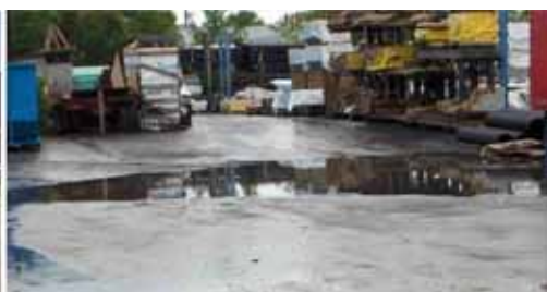
Figure 17 : Mare d'eau influençant le freinage
