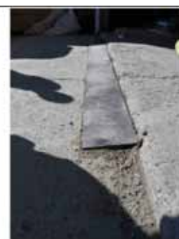
Dénivelé à l'entrée des hangars
