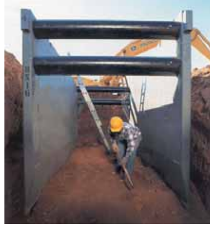
(b) «Steel Trench Shields » de Cormier (Source : Cormier, 2006)
