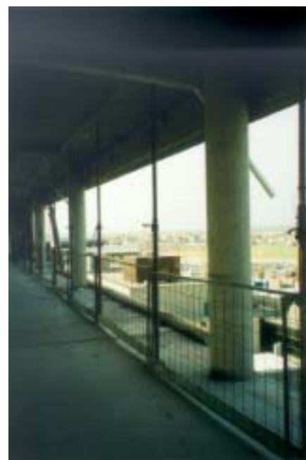
Figure 16 : Cadre en treillis métallique comme garde-corps
