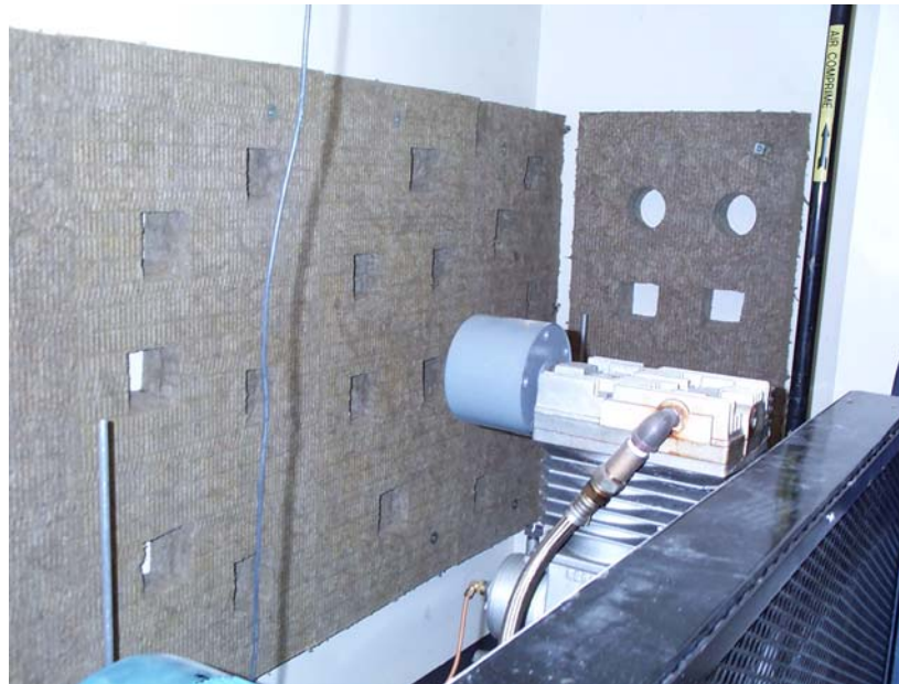
Figure 7 – Une vue du traitement partiel des murs du local avec de la laine minérale macro-perforée
