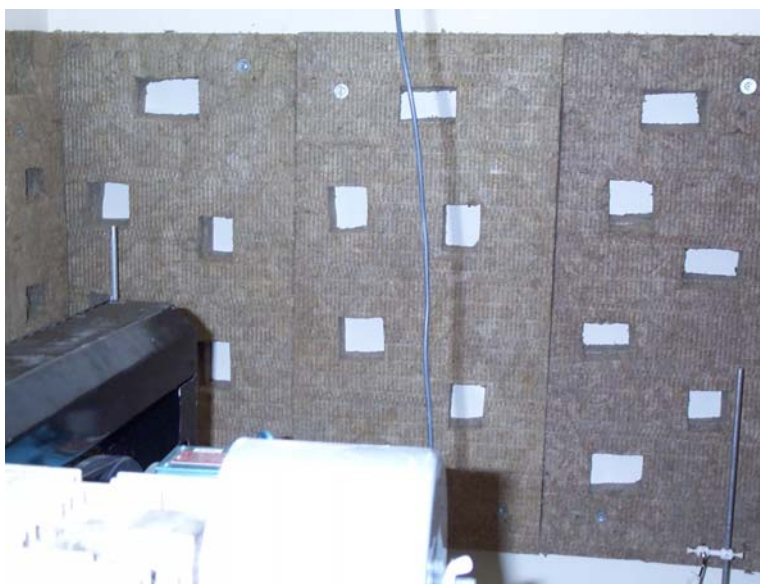
Figure 8 – Autre vue du traitement partiel des murs du local avec de la laine minérale macro-perforée
