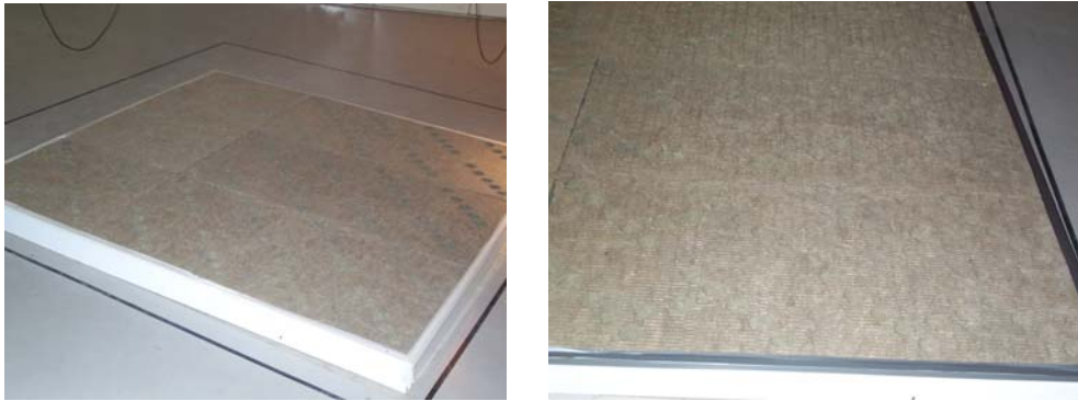
Figure 42: Photos de traitements partiels avec armature
