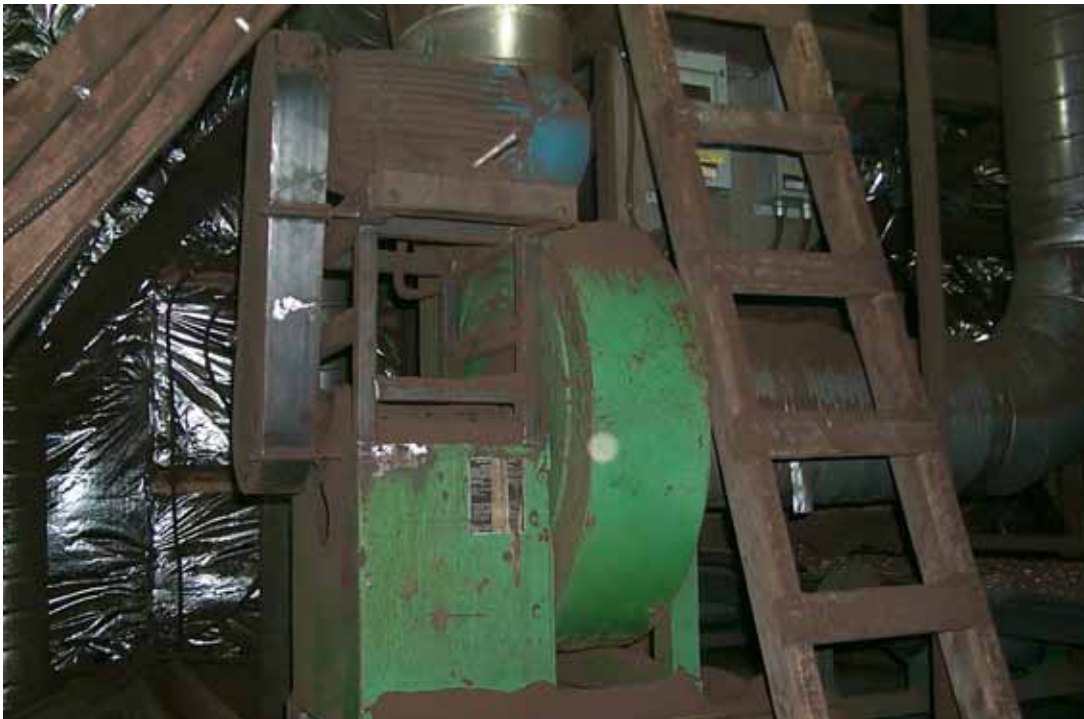
Photo 17 : Accumulation de poussières.
