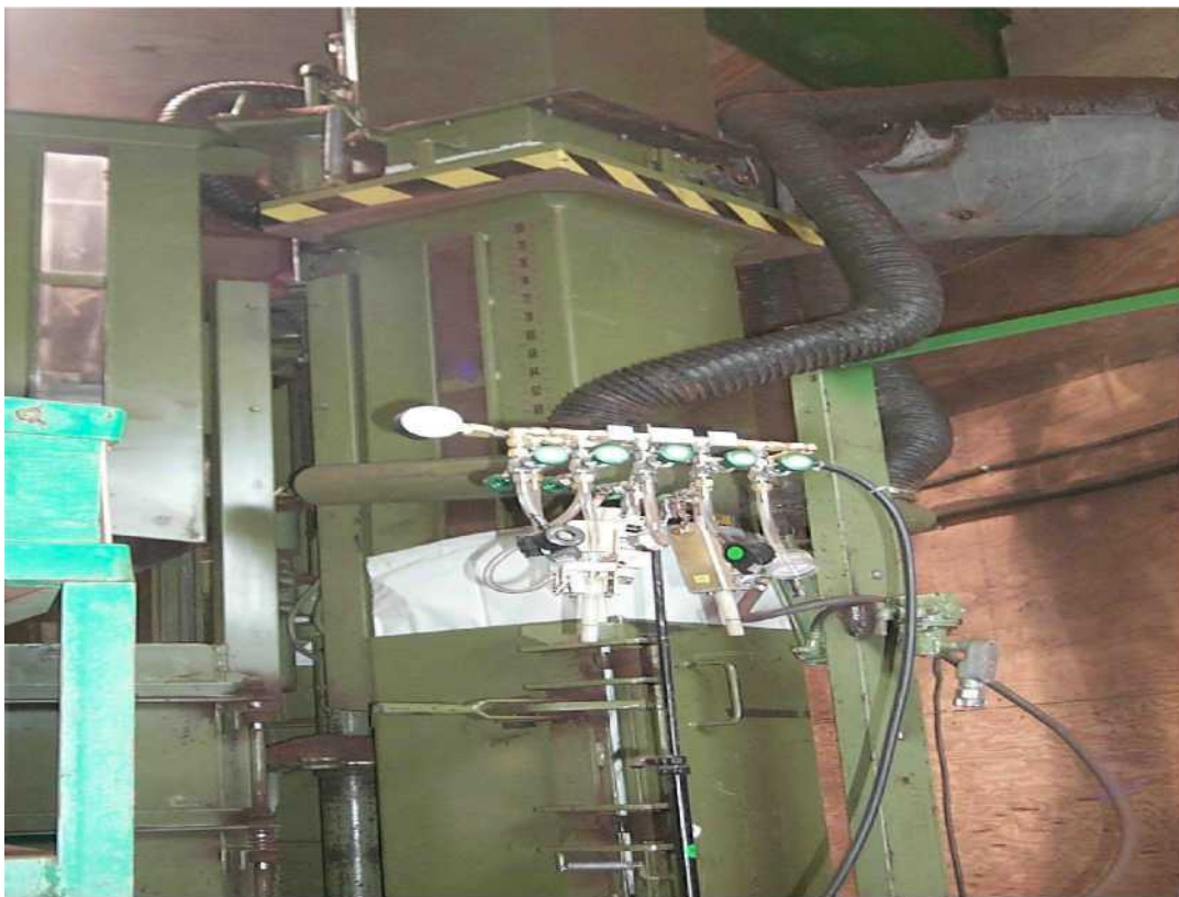
Photo 2 : Capteurs mobiles au poste de remplissage.
