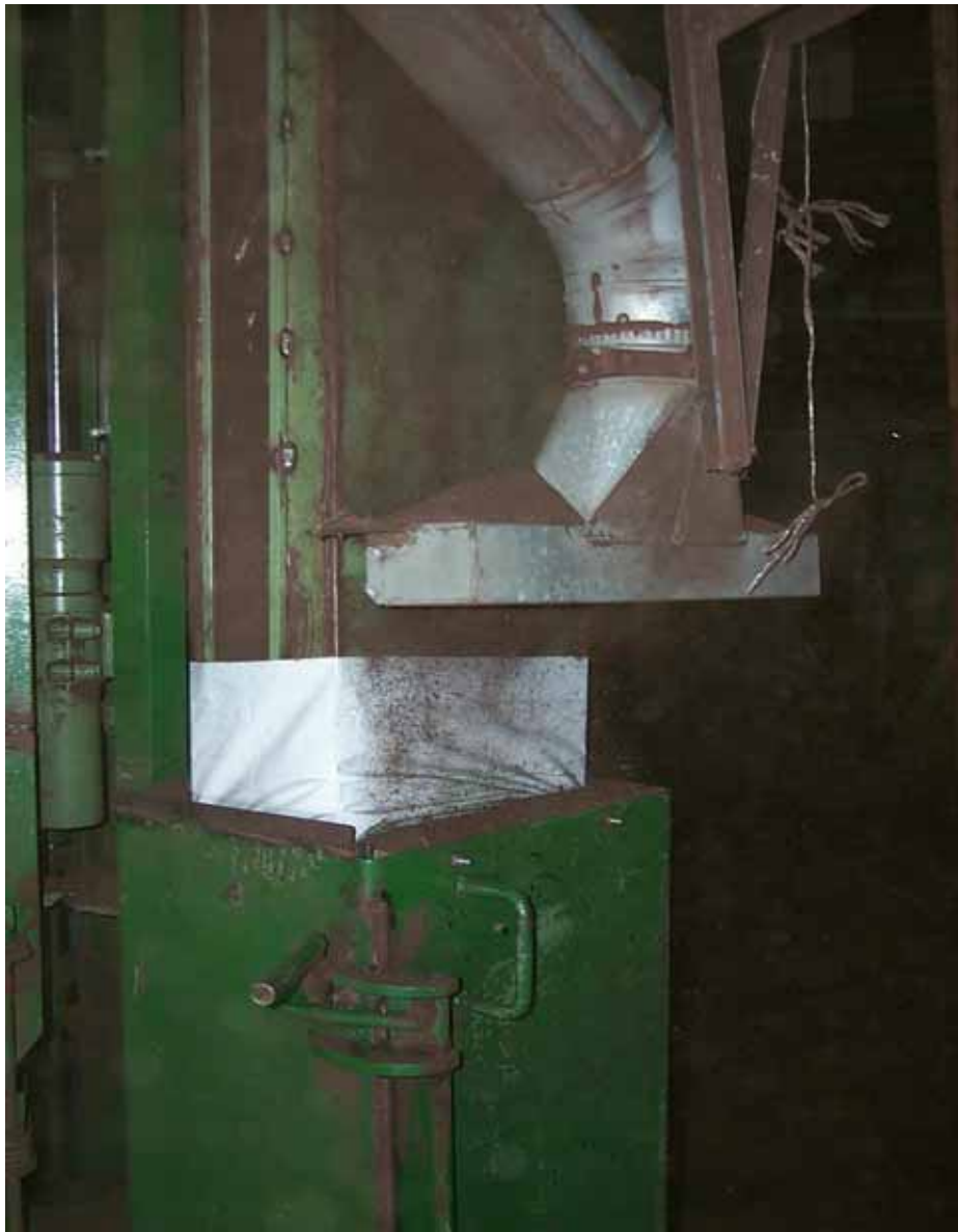
Photo 6 : Captage partiel des émissions.
