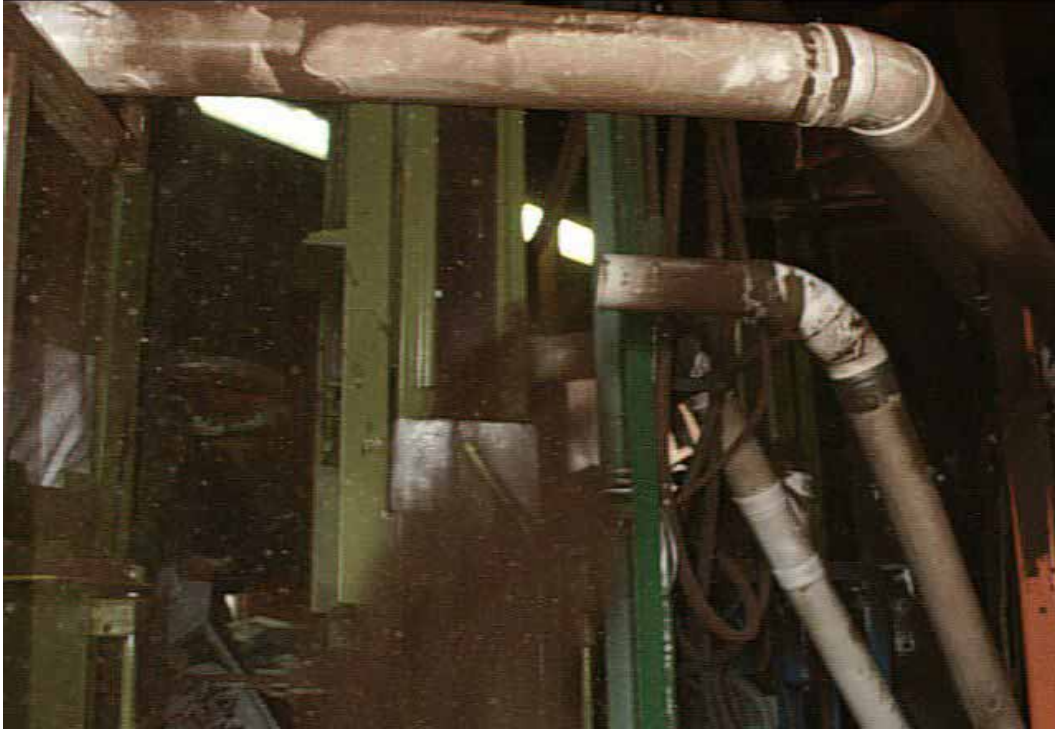
Photo 15 : Captage partiel des émissions.
