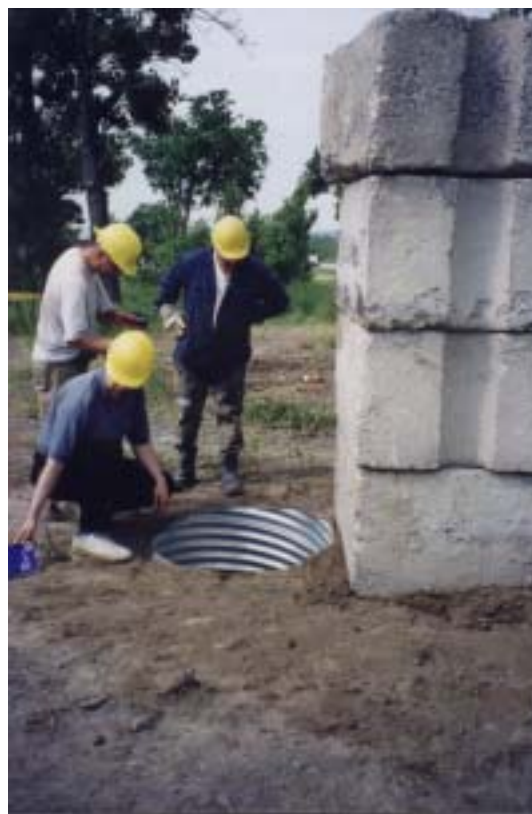
Figure 3.17 - Essai 1.1.B : Surcharge par des blocs posés près du TTAOG-36 Ville de Longueuil
