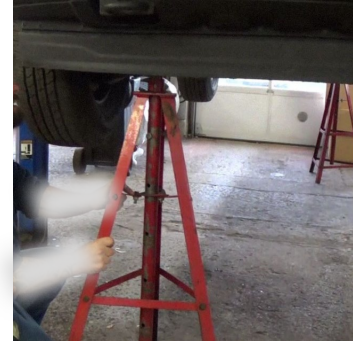
Chandelles à ajustement par vis, installées à l'avant et à l'arrière, en diagonale
