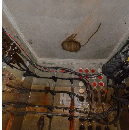
Figure 10. Vue intérieure d'un puits d'accès électrique, présence d'une 2 e ouverture pour le pompage de l'eau et la ventilation (ED_ID : 1; solution n° 21).
