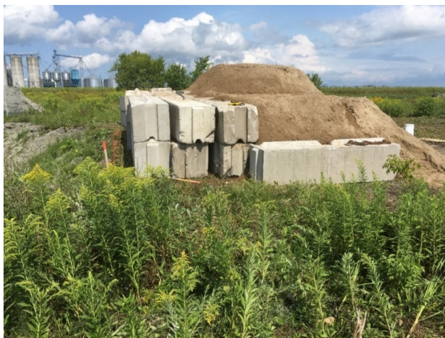
Figure 31. Arrangement du sable et des blocs de béton sur le bord de la tranchée A-2.
