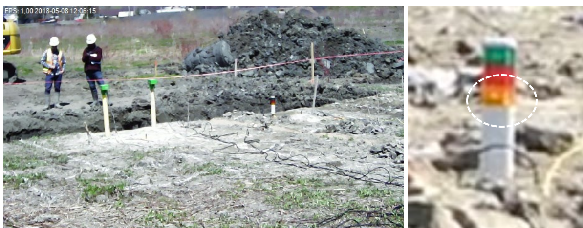
Figure 35. Feu jaune clignotant du dispositif d'alerte D1 après détection du deuxième phénomène de fluage avant effondrement.
