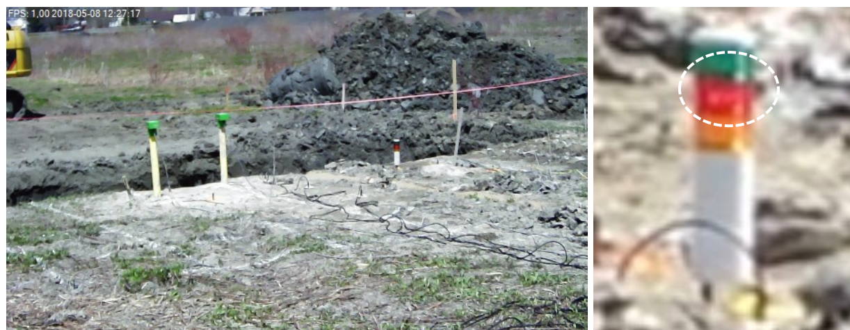
Figure 36. Feu rouge clignotant du dispositif d'alerte D2 après détection du troisième phénomène de fluage avant effondrement.
