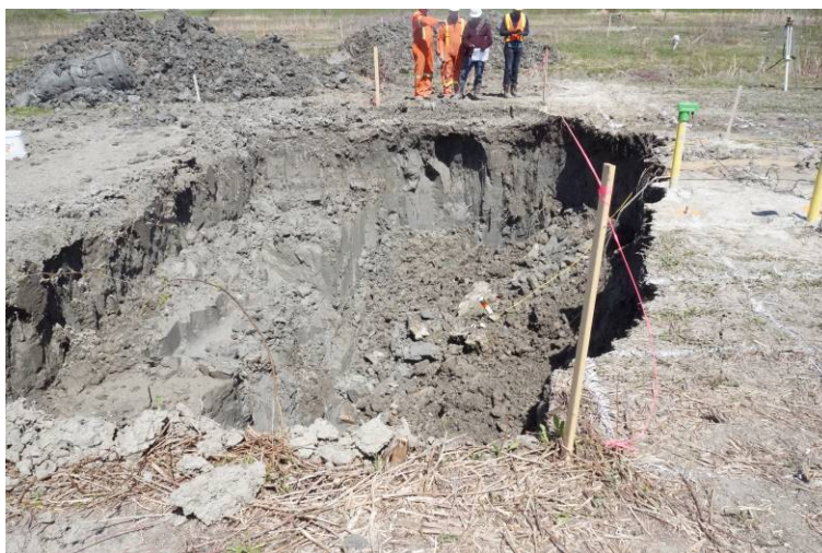
Figure 29. Rupture de paroi verticale à une profondeur de 5 m, entraînant le MPSM au fond de la tranchée.
