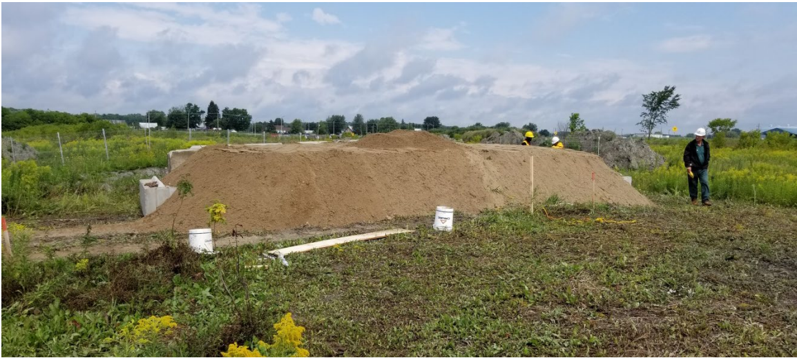
Figure 26. Chargement de la tranchée A2 avec des blocs en béton et du sable.
