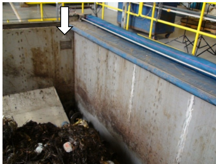
Figure 18 : Bouche d'extraction d'air de la benne de réception de l'usine B.
