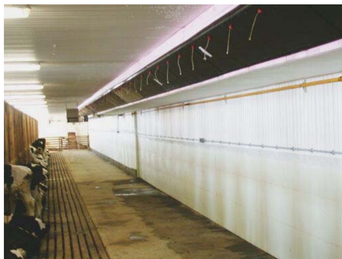
Figure 8. Entrée d'air latérale de la salle évaluée sur le site no. 3.
