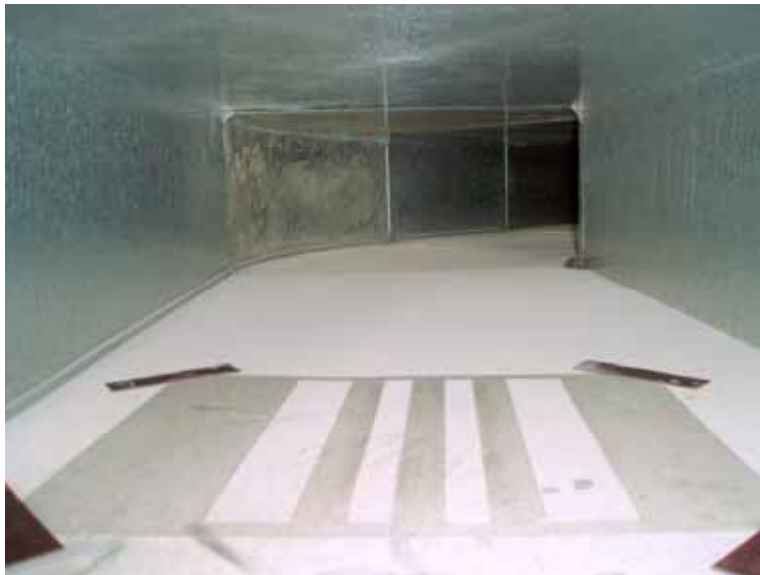
Figure 1 : Conduit de retour avec le gabarit de prélèvement
