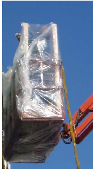
Figure 4 : Abri non conforme sur une plate-forme de travail élévatrice automotrice
