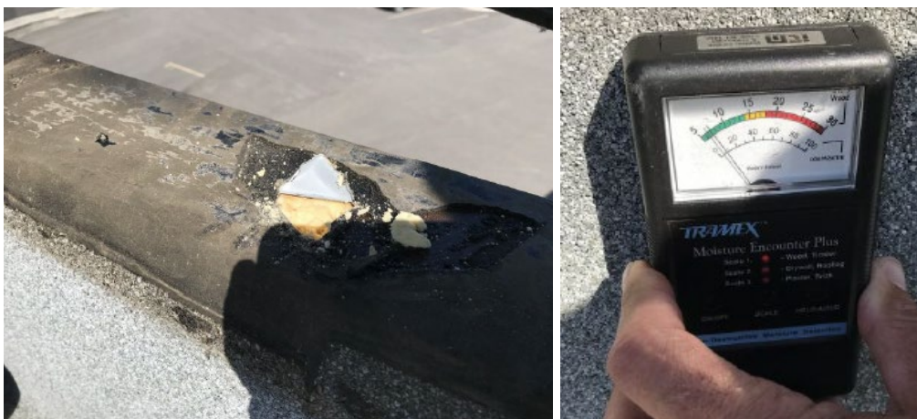
Figure 39. Coupe exploratoire et mesure d'humidité à proximité du parapet 4.
