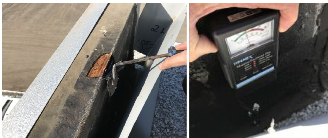
Figure 35. Coupe exploratoire et mesure d'humidité à proximité du parapet 2.
