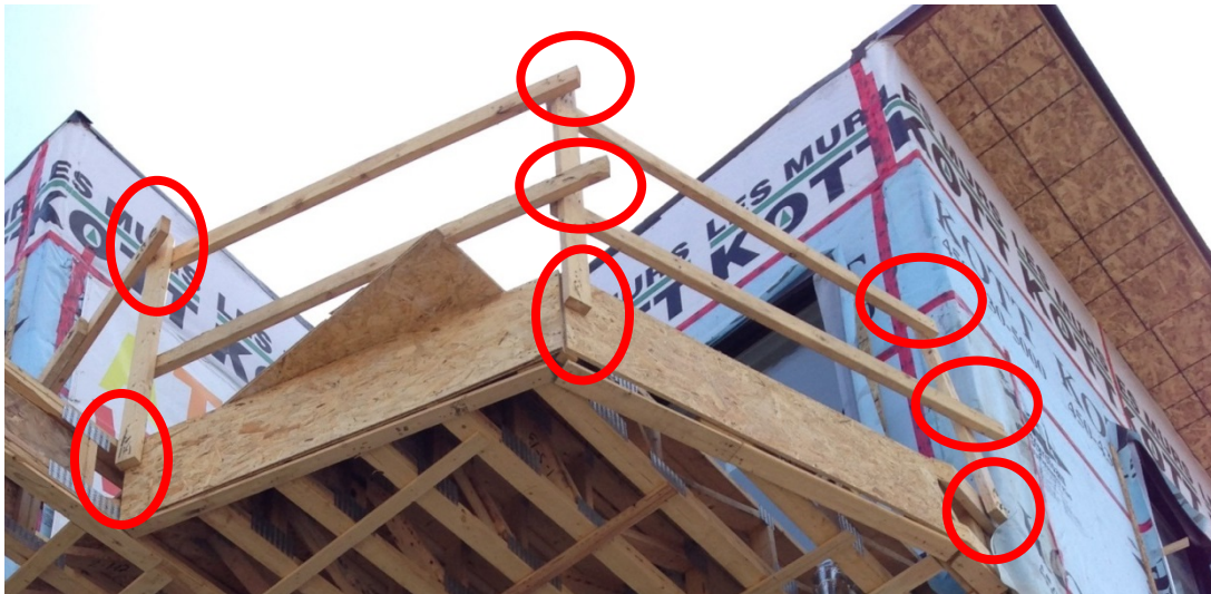
Figure 2. Garde-corps temporaire en bois (apparaît non conforme au CSTC).
