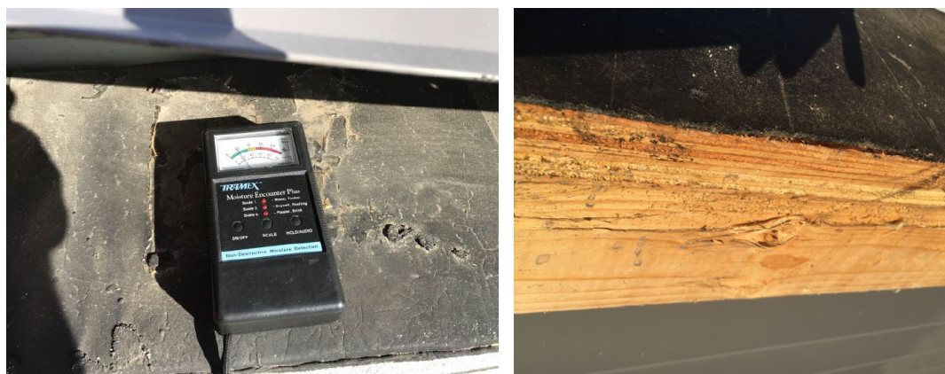
Figure 36. Coupe exploratoire et mesure d'humidité du parapet 3.
